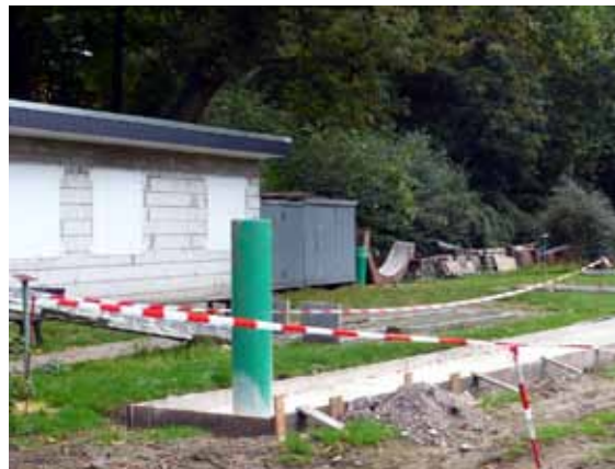
Die Einschalung für den Pfosten des Auffangkastens und die Bahnbegrenzungen sind schon deutlich zu sehen.
